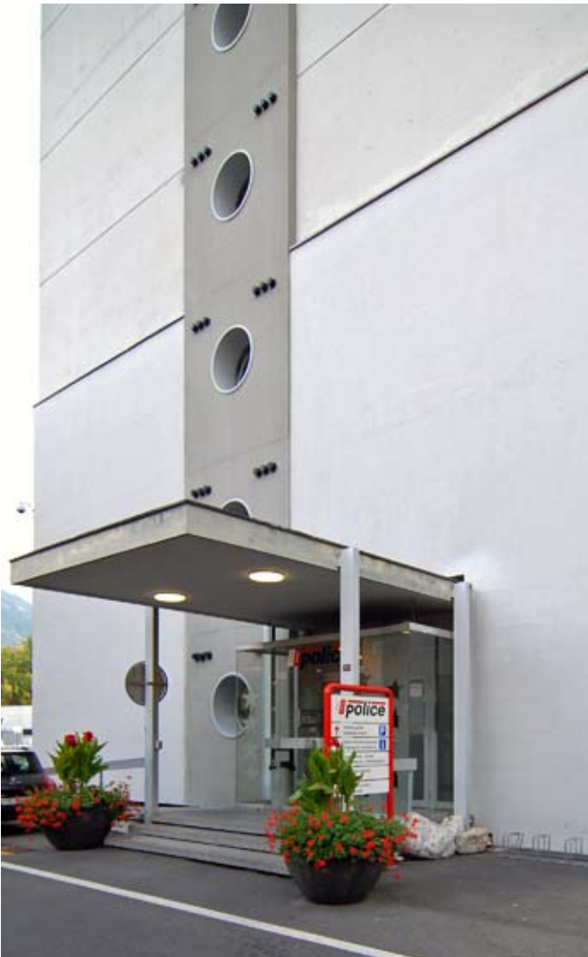
Querfassade des Altbaus mit den von aussen sichtbaren Verankerungen der Spannglieder auf Höhe jeder Geschossdecke.
