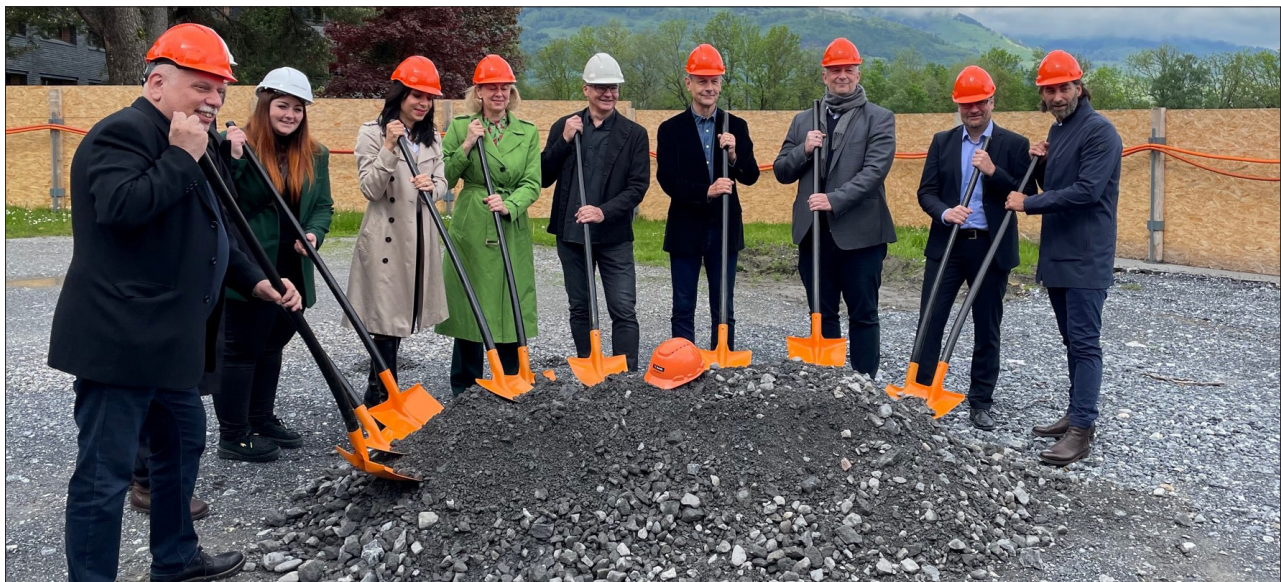
Angepackt. Die Arbeiten rund um die Erweiterungsbauten des Schulzentrums Mühleholz I und II sind auf Kurs.
