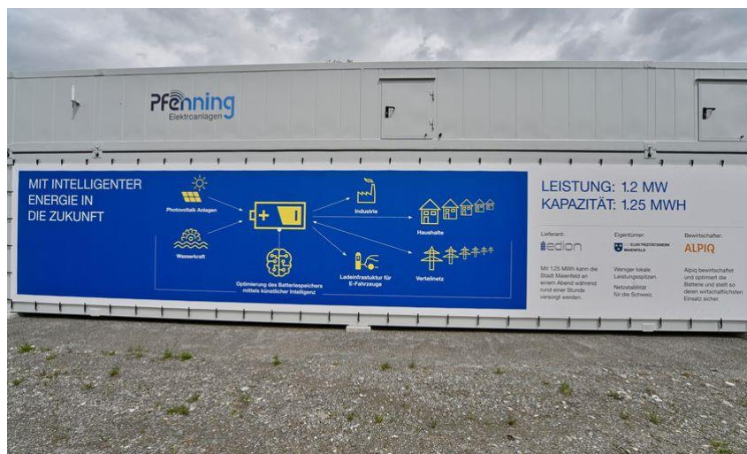
Abbildung 51: Batteriespeicher des EW Maienfeld, 1.2 MW, 1.25 MWh, zur Lastspitzenkappung und zur Erbringung von Systemdienstleistungen (Primär- und Sekundärleistung). Bild: Alpiq.
