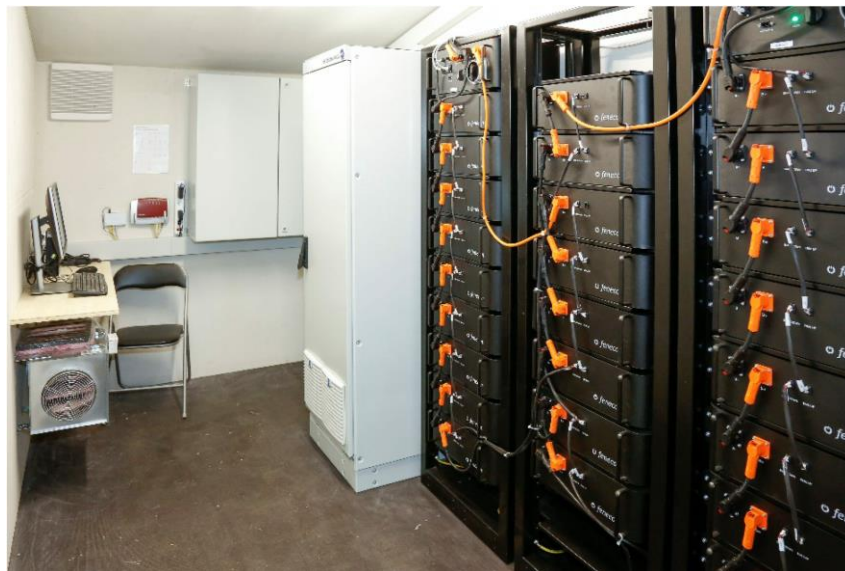
Abbildung 6: Fenecon Gewerbesystem mit MR-Gridcon Wechselrichter (2018)
