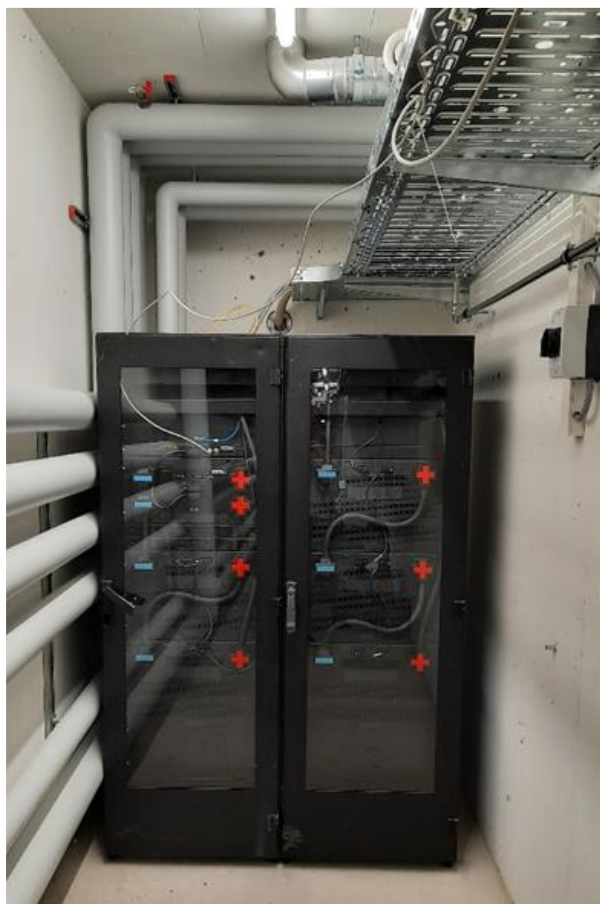
Abbildung 4: Ads-tec SRS2047 Batteriespeichersystem bei der Inbetriebnahme
