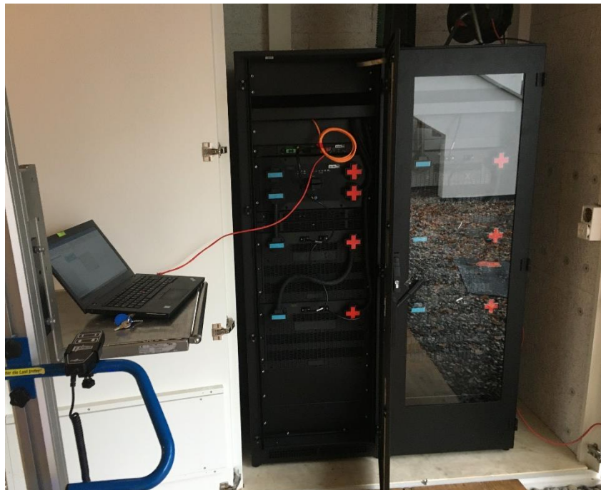
Abbildung 3: Ads-tec SRS2047 Batteriespeichersystem bei der Inbetriebnahme
