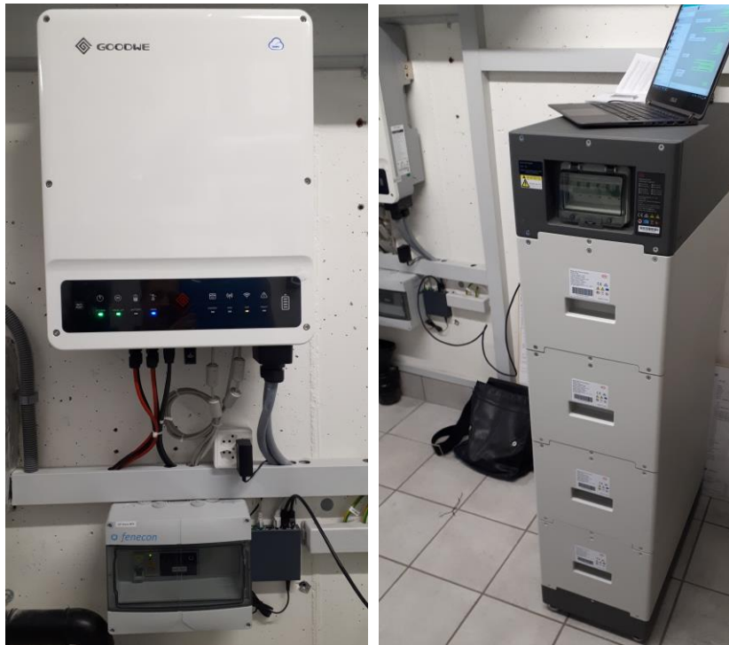
Abbildung 5: Goodwe-Hybridwechselrichter, BYD HVM Batteriespeicher
