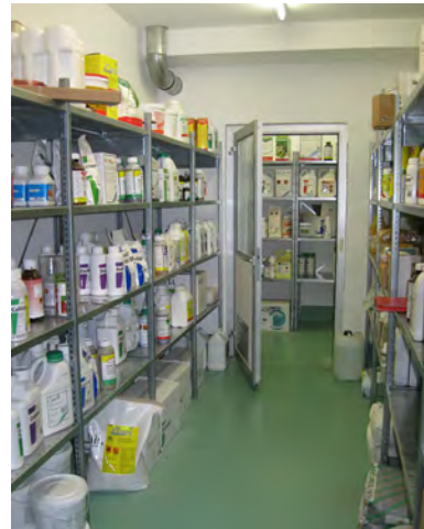
Lager für umweltgefährdende und giftige Stoffe: separater Brandabschnitt mit Lüftung und mediumbeständigem Boden.
