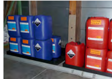
Bei Betonböden sind mindestens die Säuren in beständiger Auffangwanne zu lagern.
