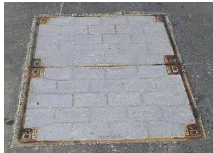
Abbildung 6 Kabelkanalisation: Einstiegschacht Ansicht oben
