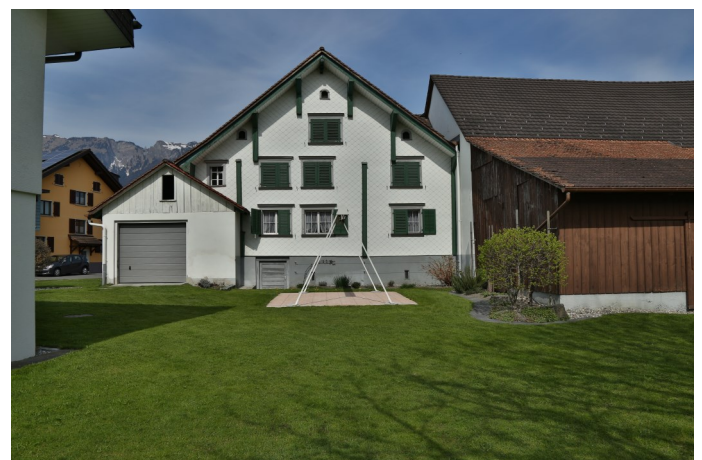
Abb. 4: Südansicht des Wohnhauses von 1701, Fensteranordnung und deren Sturzgestaltung 1885, Verkleidung in Faserzementschiefer Mitte 20. Jahrhundert an Stelle eines vorherigen Rundschindelschirmes.
