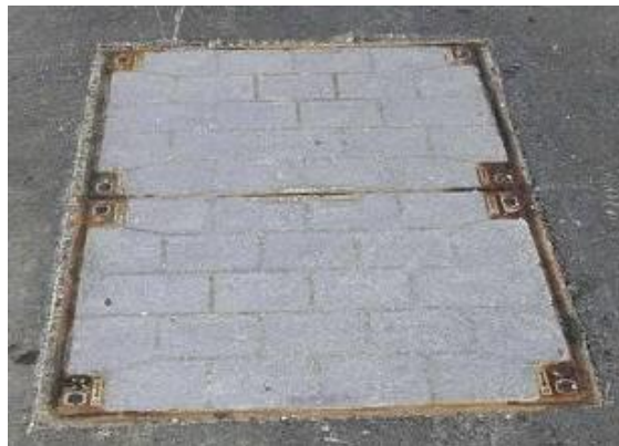
Abbildung 6 Kabelkanalisation: Einstiegschacht Ansicht oben
