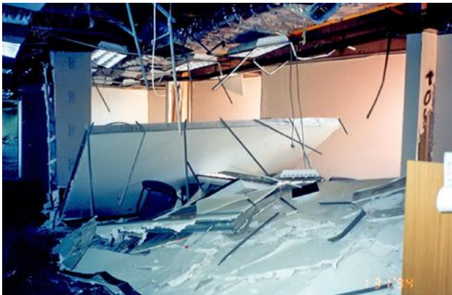
Abb. 2.4.3 und 2.4.4 > Schäden an Leichtbauwänden
