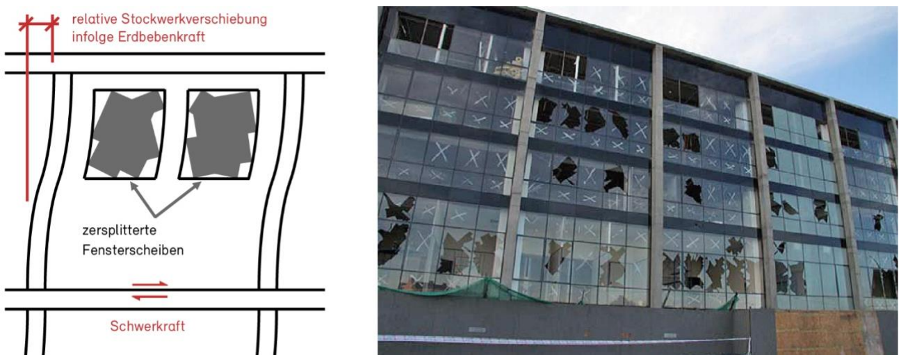
Abb. 1.3: Schäden an Fensterfronten, Chile Erdbeben 2010
