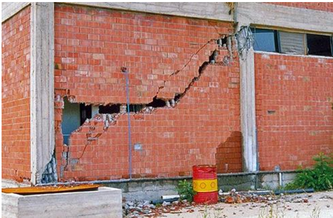
Abb. 2.4.1 > Druckdiagonale durch Mauerwerkswand und Schädigung der Stahlbetonstützen
