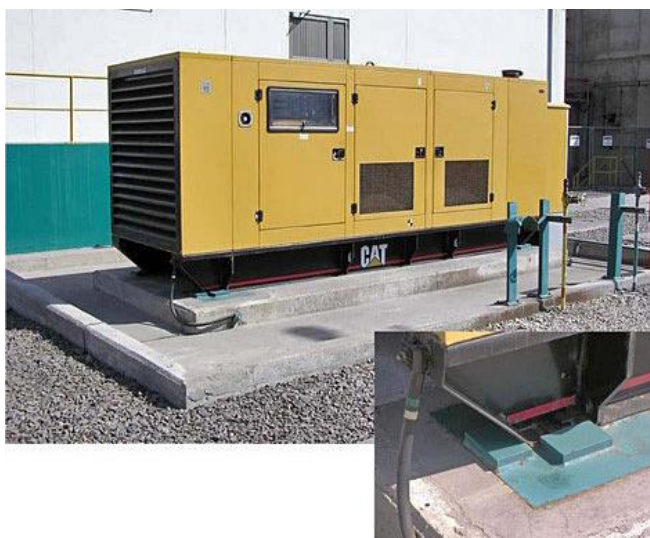
Abb. 2.16.7 > horizontaler Anschlag bei Generator
