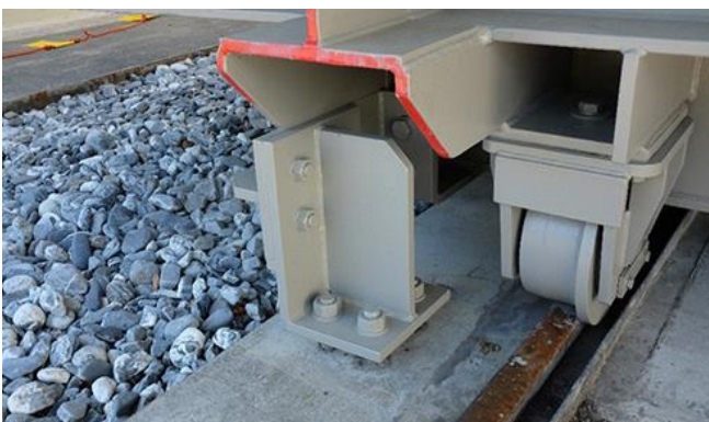
Abb. 2.14.3 > Verankerung eines Transformators auf Fahrrollen
