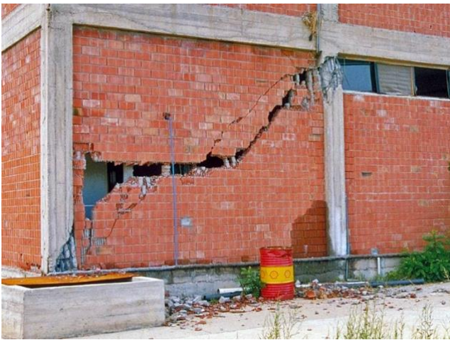
Abb. 1.4: Schäden an Stützen durch Mauerwerksausfachung, Türkei Erdbeben 1998
