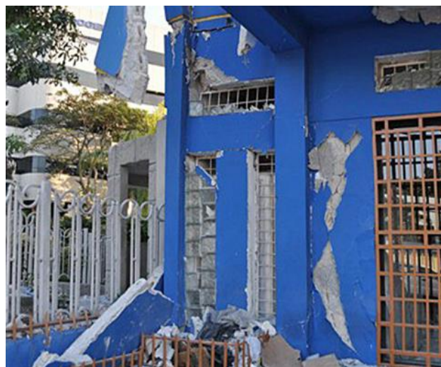
Abb. 2.8.3 > Schäden an Verglasung mit Glasbausteinen
