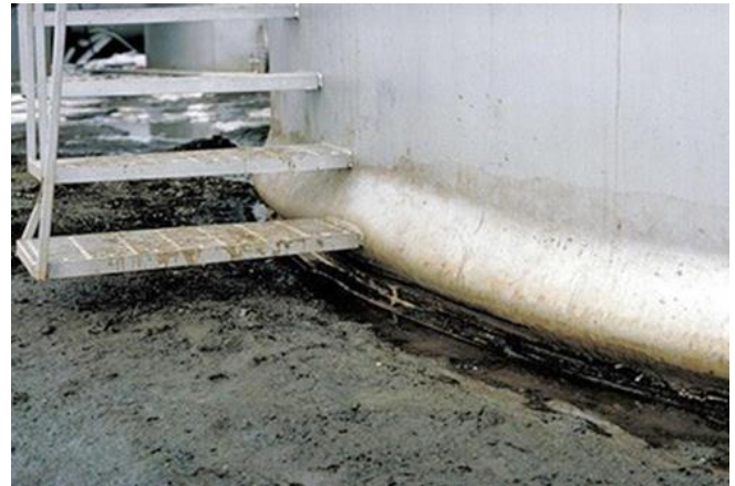
Abb. 2.17.4 > Ausgebeulte Tankwand (sog. «Elefantenfuss»)
