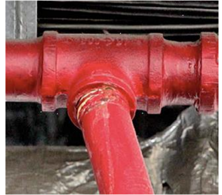
Abb. 2.18.3 > Schaden bei Verzweigung
