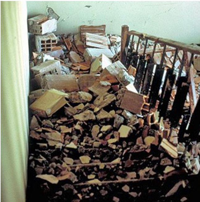
Abb. 2.7.3 > Trümmerteile versperren den Treppenlauf
