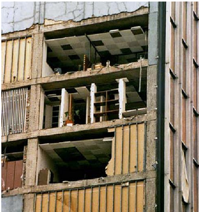
Abb. 2.5.3 > Versagen aus der Ebene einer vorgehängten Fassade
