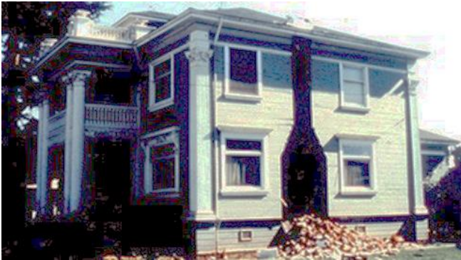
Abb. 2.10.1 > Einsturz eines Kamins
