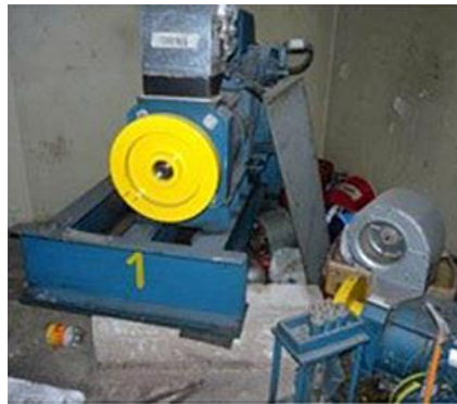
Abb. 2.19.2 > Ungenügend befestigte Antriebseinheit
