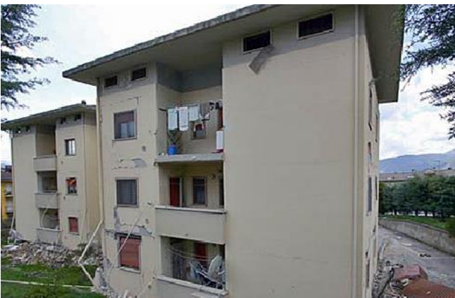
Abb. 2.6.3 > Brüstung im oberen Geschoss herausgefallen
