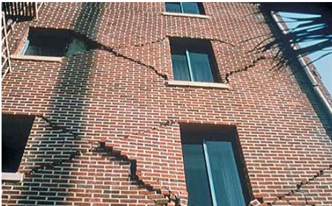
Abb. 2.5.1 > Kreuzrisse zwischen Fenstern
