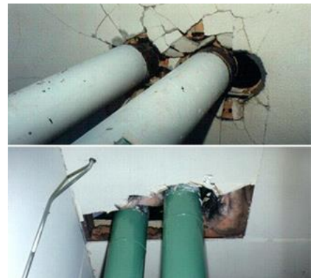
Abb. 2.18.6/2.18.7 > Schaden bei Wanddurchbrüchen
