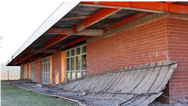
Abb. 2.10.3 und 2.10.4 > Abgelöste Deckenuntersicht und Abplatzungen in Verputz
