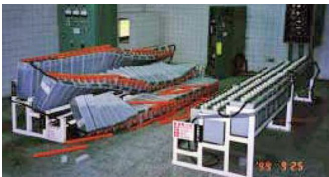
Abb. 2.11.1 > Schäden an Regal für Notstrombatterien und Herausfallen der Batterien
