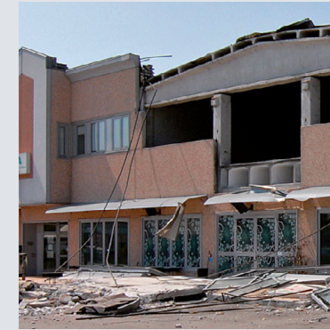
Abgestürzte Fassadenbauteile (Emilia Romagna, Italien, 2012)
