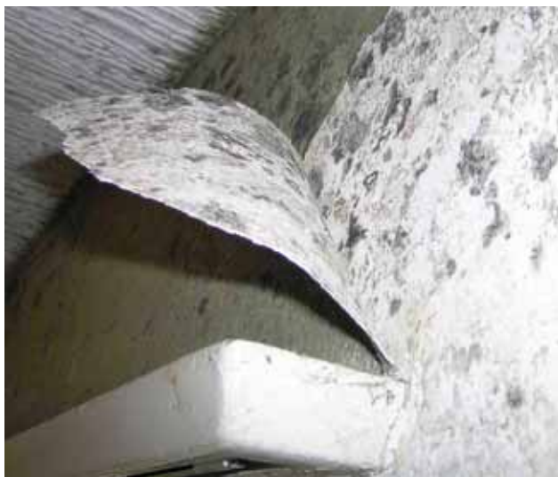
Bild 2: Schimmelpilzbefall auf der Tapete und dem darunterliegenden Verputz (Befall tiefer liegender Schichten).
