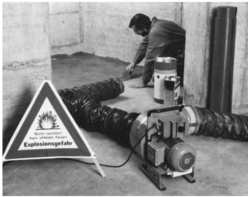
Bild 5: In Kellern ist eine künstliche Absaugung nötig. Bei Bedarf müssen tragbare Ventilatoren eingesetzt werden.
